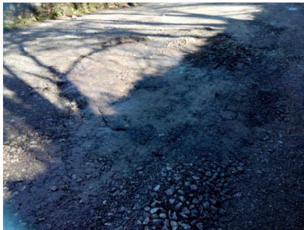
DETALLE DO ESTADO DO FIRME
