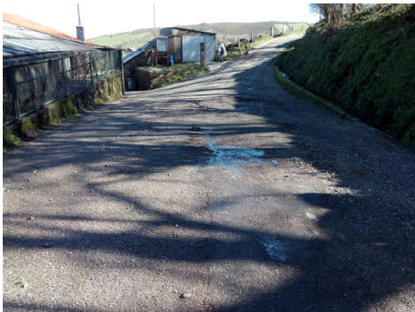
VISTA DA ZONA MÁIS DETERIORADA DO TRAMO DE ACTUACIÓN. SOBREANCHO 2ª INTERSECCION
